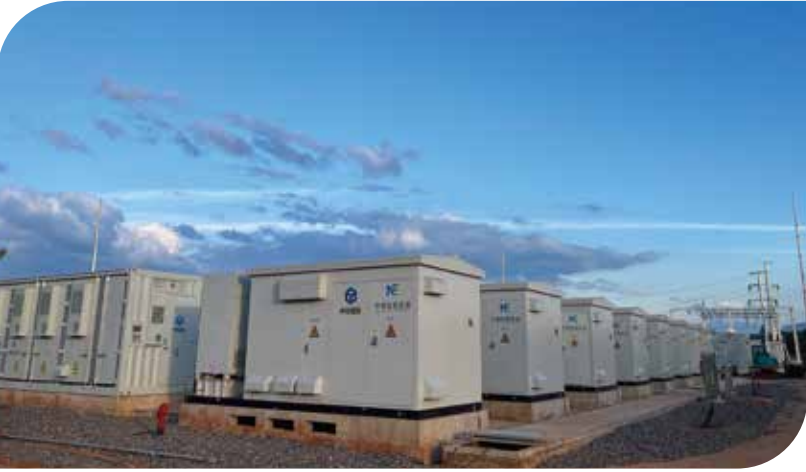
▶ 湖南永州100MW/200MWh共享储能项目
